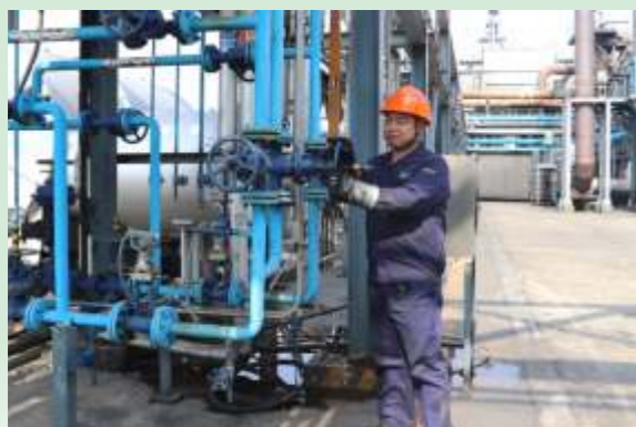
化工公司炭黑一车间维修值长 陈俊涛
